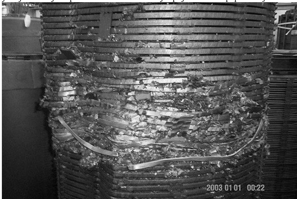
Slika 5. Razoren namotaj i papirna izolacija namotaja transformatora
